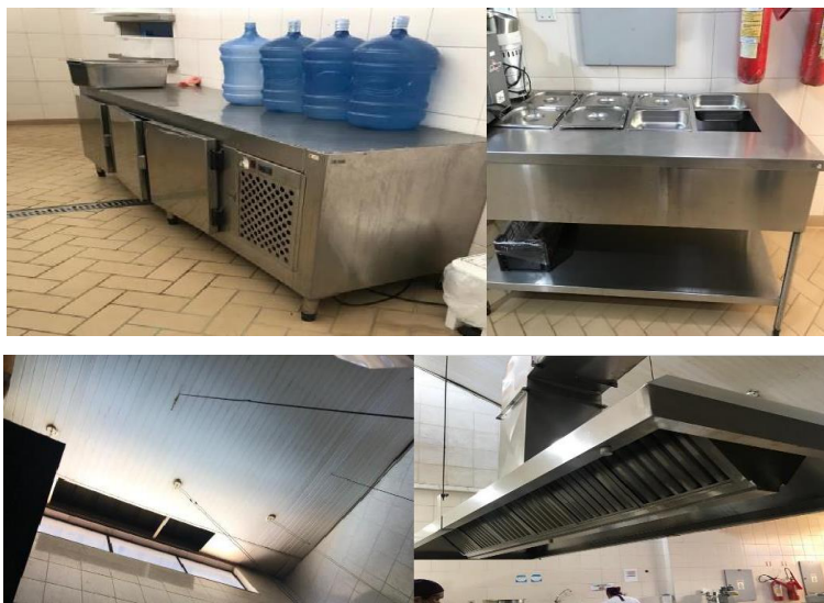
Figura: Exaustor/coifa, Buffet térmico, forro de PVC com aberturas e fiação elétrica exposta na área de preparo e gelopar do SND.
