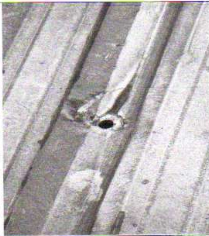
FUROS NA TELHA
